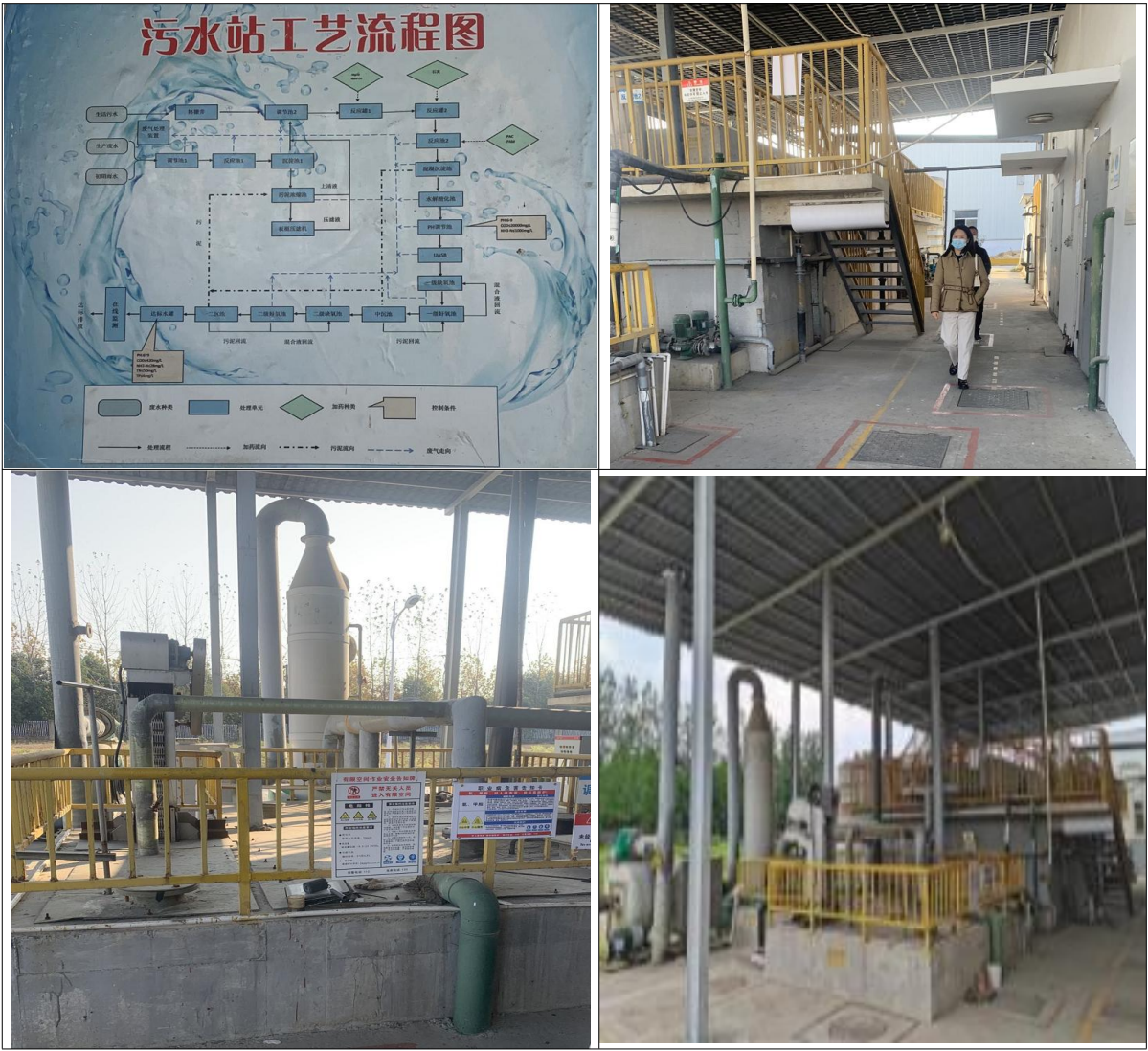
图 3-4 污水处理设施照片
