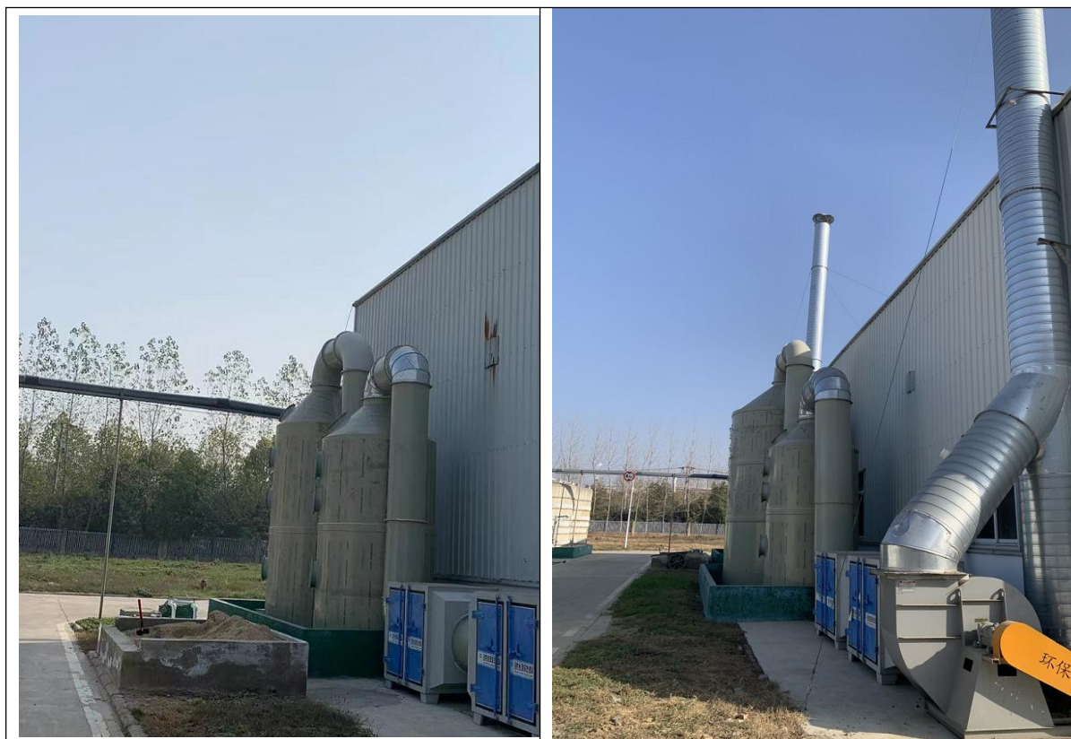
图 3-2 废气处理设施照片
