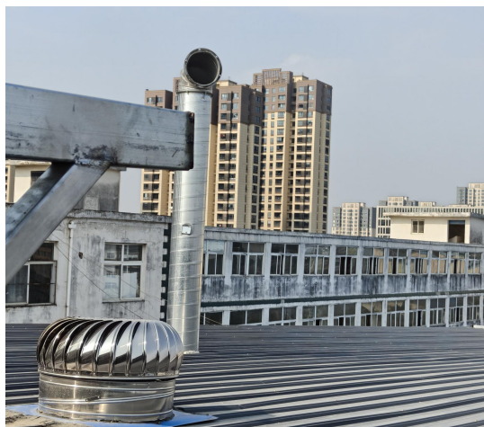
二级活性炭吸附装置排气筒
