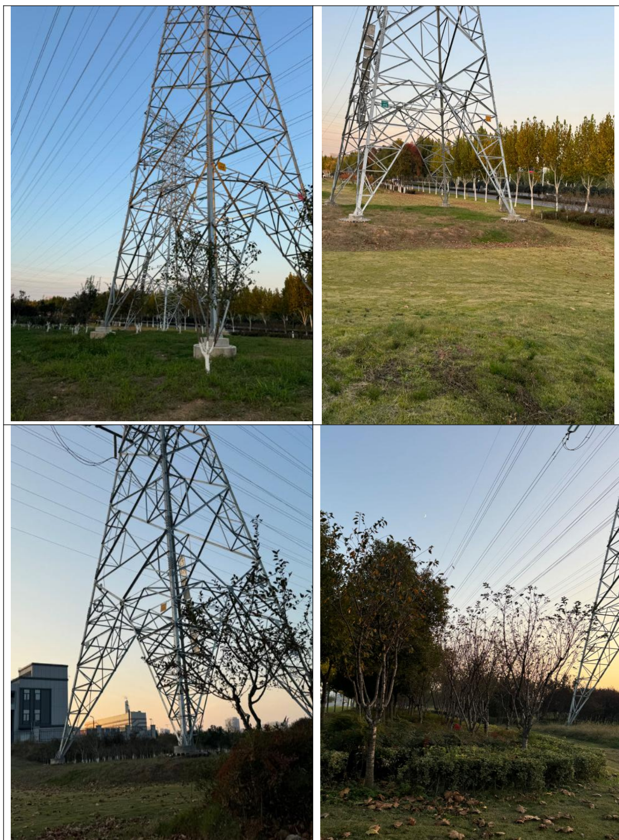
图6-3 本项目塔基植被恢复现状照片
