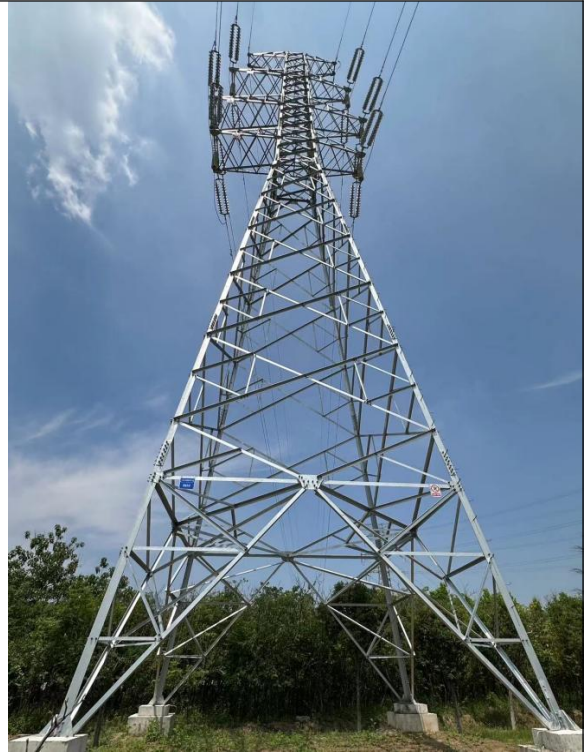
本工程角钢塔（双回路）
