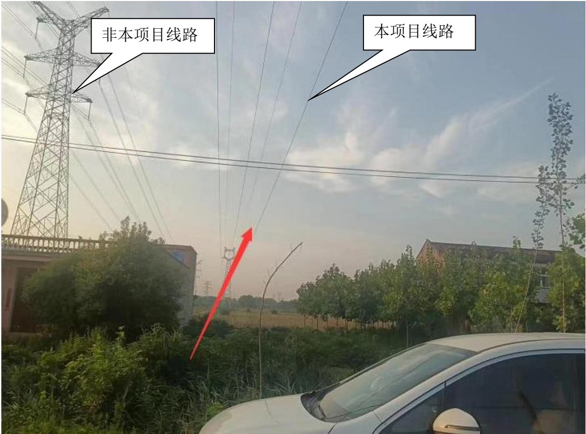
图7-1 本工程110kV万通风电811线路051#~052#塔照片
